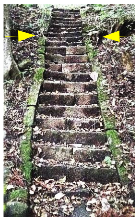
図2. 地震断層による八幡神社石段の変形。矢印部分の縁石が崩れている。
